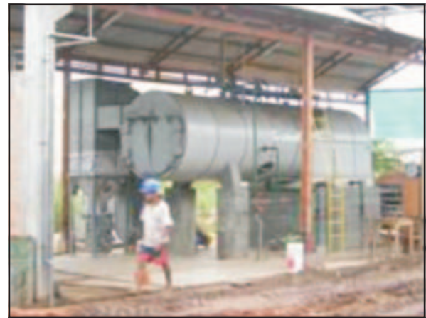
FOTO 4: NUEVO CALDERO ALIMENTADO CON ASERRÍN
